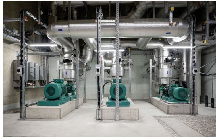
Leistungsstarke Pumpen fördern die Wärme in das Netz.
